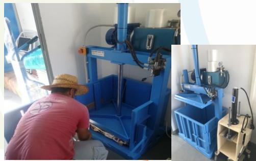
Χώρος επεξεργασίας (συμπίεση/δεματοποίηση)
